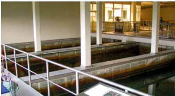
Foto Filterbecken (im Hintergrund der Leitstand)
